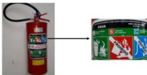
Figura 02. Extintor de incêndio água
